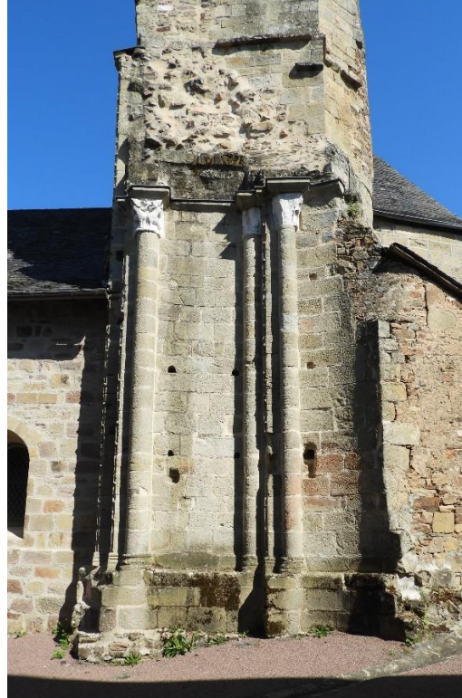
Vestiges sur façade Sud
